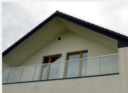
Czerpnię powietrza umieszczono pod samym okapem dachu, na ścianie północnej.
