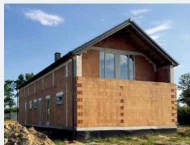
📌 Część nośną muru wzniesiono ze szlifowanych poryzowanych pustaków ceramicznych o grubości 38 cm.
