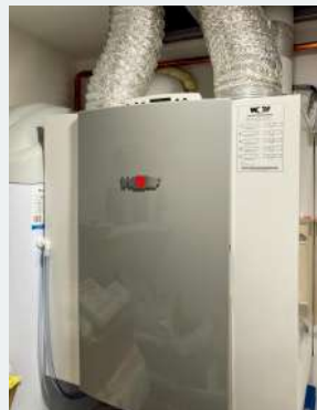
Centrala wentylacyjna znajduje się w pomieszczeniu gospodarczym, w łatwo dostępnym miejscu.
