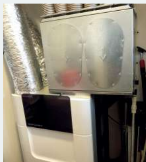
Centrala wentylacyjna o wydajności 450 m 3 /h znajduje się w kotłowni przy garażu.
